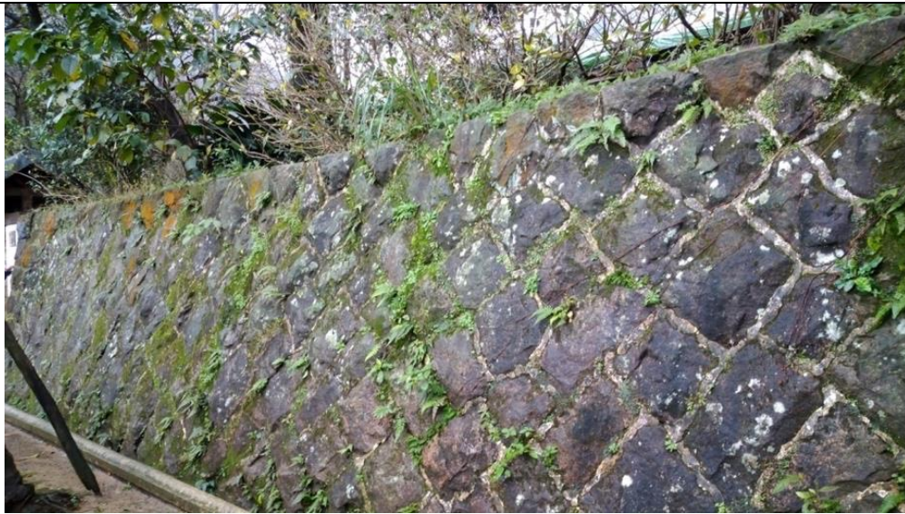
【DH-K02-圖 1】金瓜石太子賓館外牆駁坎局部縫隙已使用水泥砂漿填補
