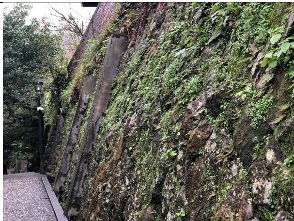
【DH-K04-圖 5】東側駁坎面可見水泥製落水管飾材
