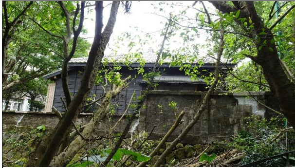
【DH-K01-圖 1】入口左側圍牆沿駁坎上緣興建，駁坎與圍牆接合處有縫隙
