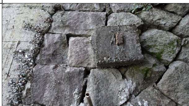
【DH-S01-圖 4】水湳洞職工宿舍駁坎外加鋼筋、水泥塊
