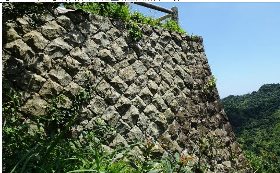
【PF-K02-圖 6】駁坎最上方平台現在設手水泥欄杆
