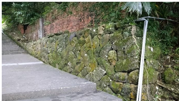
【DH-K03-圖 1】階梯邊施作駁坎做為建築用地基礎，與階梯之間留有排水溝
