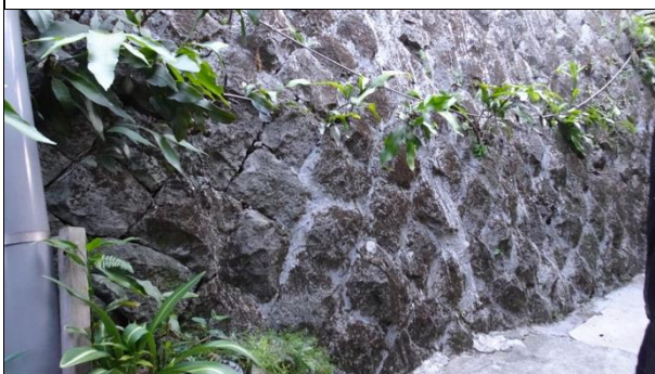
【DH-S02-圖 14】日治時期斜角砌駁坎縫隙填注水泥
