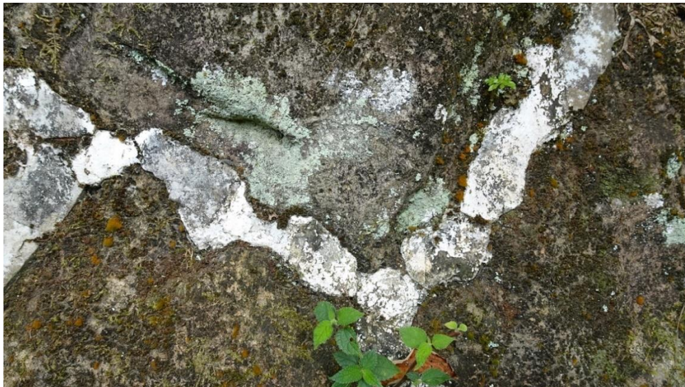
【DH-K02-圖 3】金瓜石太子賓館外牆駁坎使用水泥砂漿填補之近照
