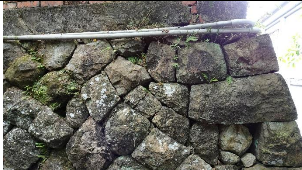
【DH-K04-圖 3】東側轉角有缺石，部分石材有龜裂狀況，石材有鬆動現象
