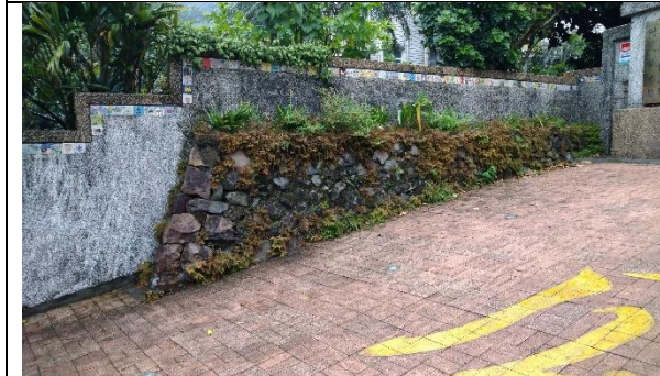
【PF-K01-圖 3】校門左側矮牆駁坎，已使用水泥進行加固
