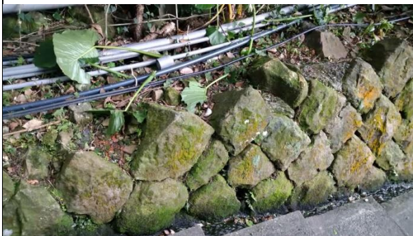
【DH-K03-圖 2】採間知石斜角砌工法，上方天端石已不見
