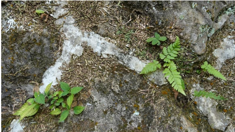
【DH-K02-圖 2】金瓜石太子賓館外牆駁坎使用水泥砂漿填補之近照
